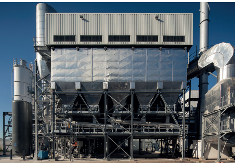
Les fumées provenant des chaudières sont épurées dans des dispositifs performants.
